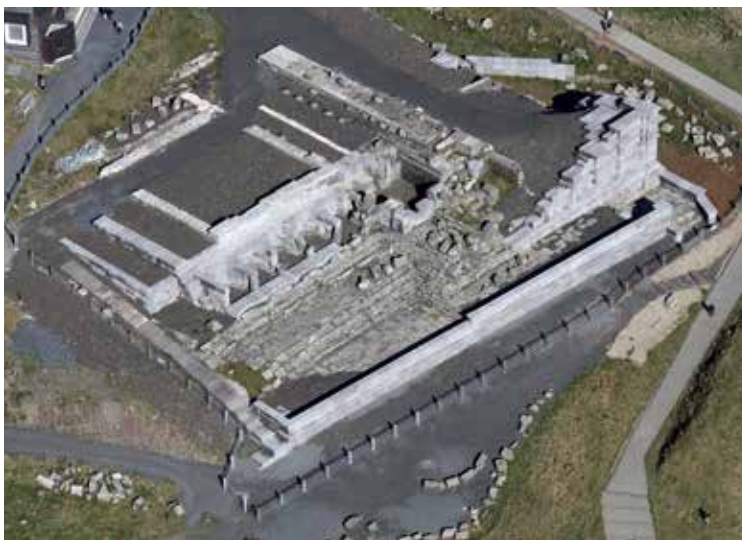
■ Le sanctuaire de Mercure en 2015, après la première phase de travaux ©4 vents
